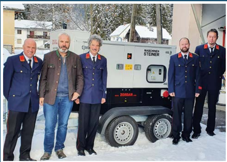
NOTSTROMAGGREGAT IM FEUERWEHRHAUS DELLACH - 80 KVA
